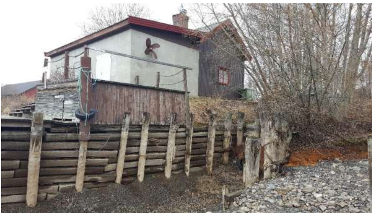
Tidligere anlegg var fra 90-tallet og i ferd med å skli ut. Ustabile grunnforhold ble avdekket også inntil bygningskroppen etter graving, der murhjørnet nærmest i dette bildet manglet fast fundament.
