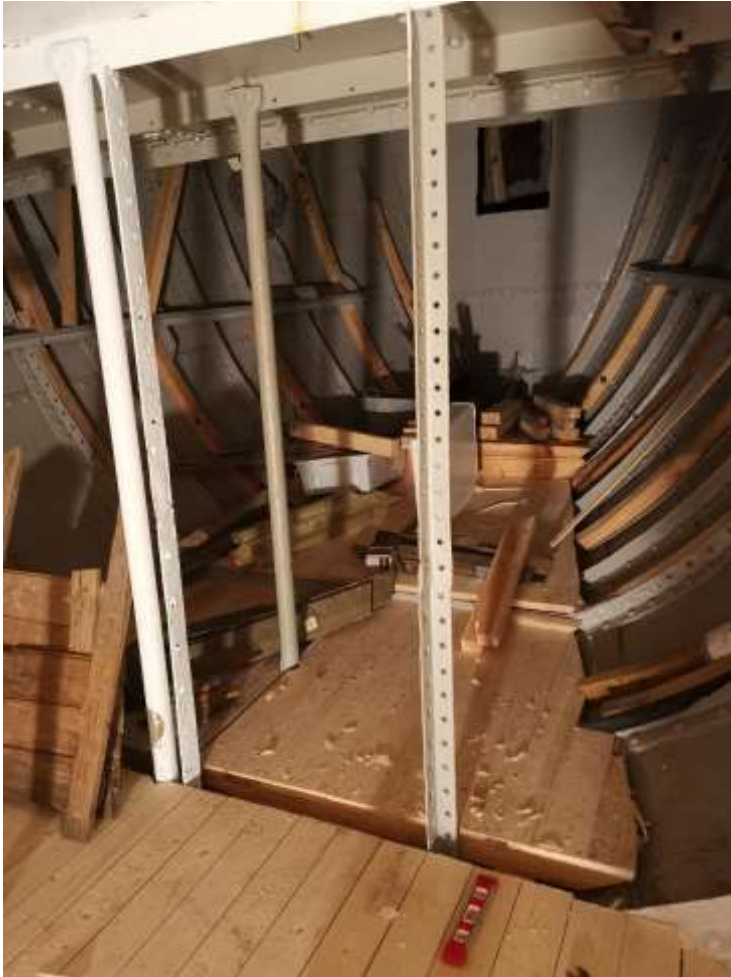
Dørk i lugarområdet er bygget slik at de enkelte elementene kan løftes til side for kontroll.
