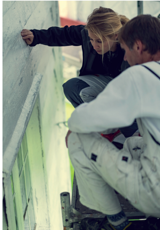
Er det noe av treverket som er skadet eller råttent, må det vurderes om materialene skal byttes ut. Foto: Fortidsminneforeningen/Bård Gundersen
