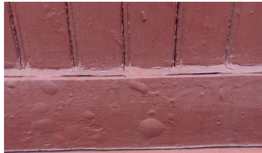
Her ser du alkydmaling malt over et eldre lag av linoljemaling, som har resultert i at det øverste laget blærer seg. Foto: Gamletrehus.no
