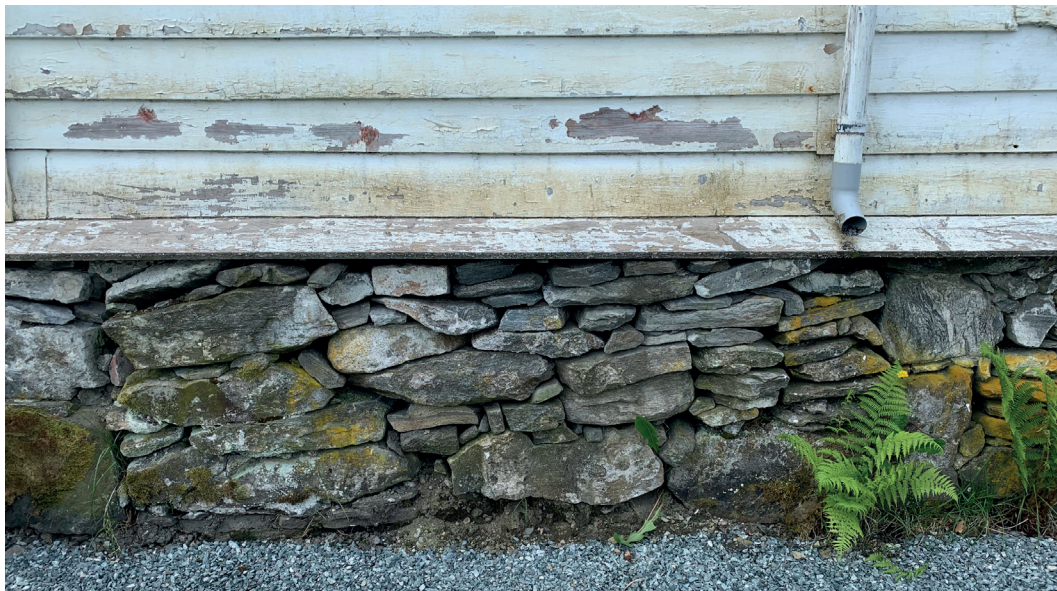
Denne takrennen er montert med falsen inn og for kort utstikk. Dette kan forårsake råteskader. Foto: Fortidsminneforeningen/Lars Erik Haugen
