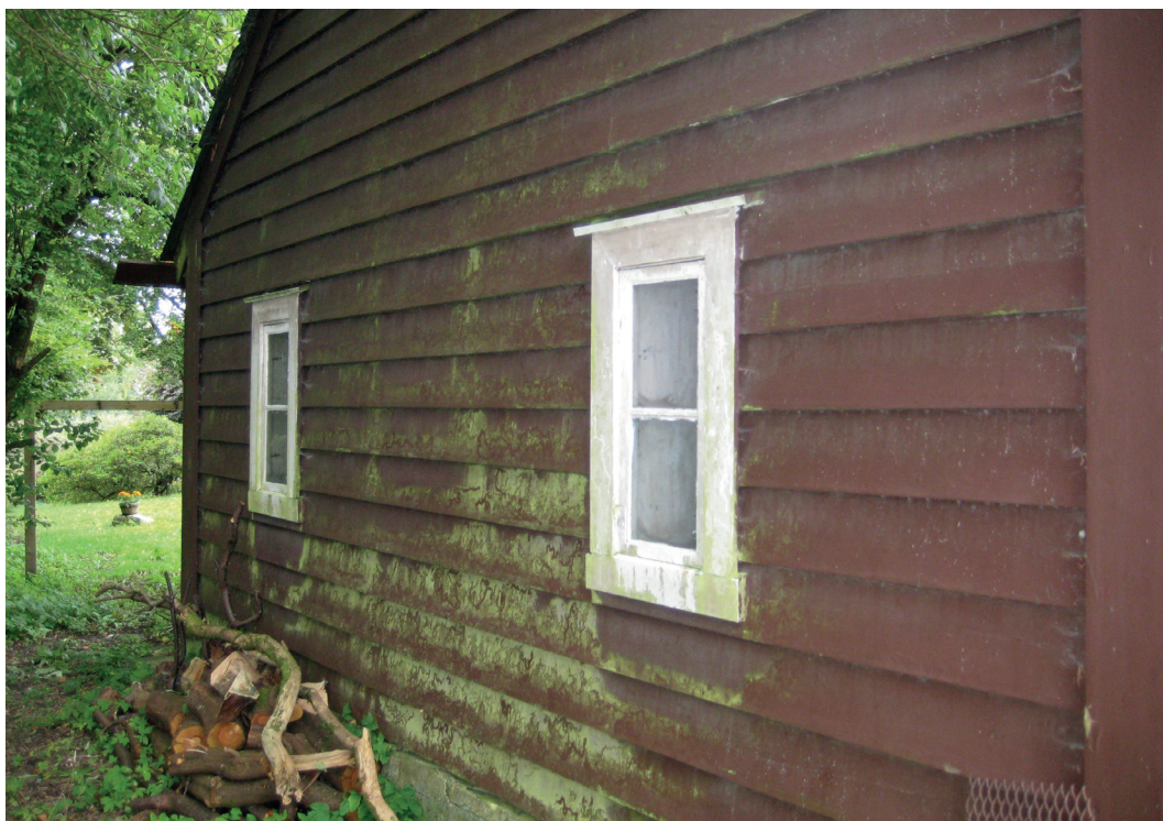
Fuktig klima og vegetasjon nær veggen gjør at yttervegger ofte får dannelse av mose og alger. Foto: Tor Meusburger
