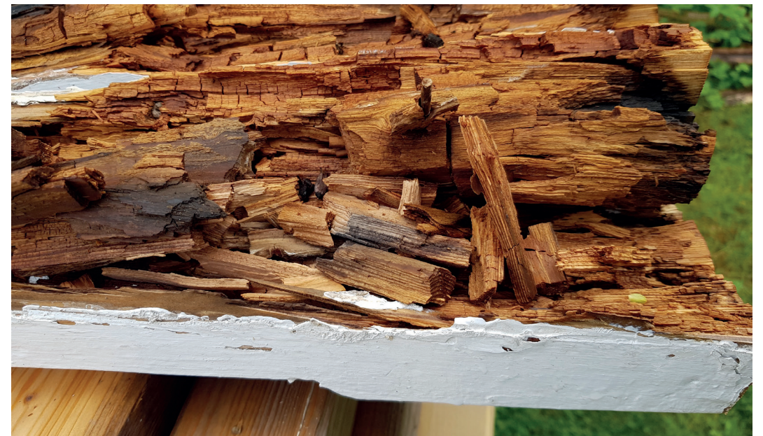
Akrylmaling danner et tett lag på overflaten. Dette gjør at fuktigheten ikke slipper ut og treverket kan råtne. Foto: Fortidsminneforeningen/Hedda Skagen Paulson
