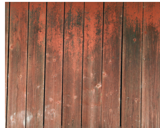
Komposisjonsmaling brytes ned over tid, det anbefales å male opp på nytt når det gamle laget er helt eller delvis nedbrutt. Foto: Fortidsminneforeningen/Ola Fjeldheim
