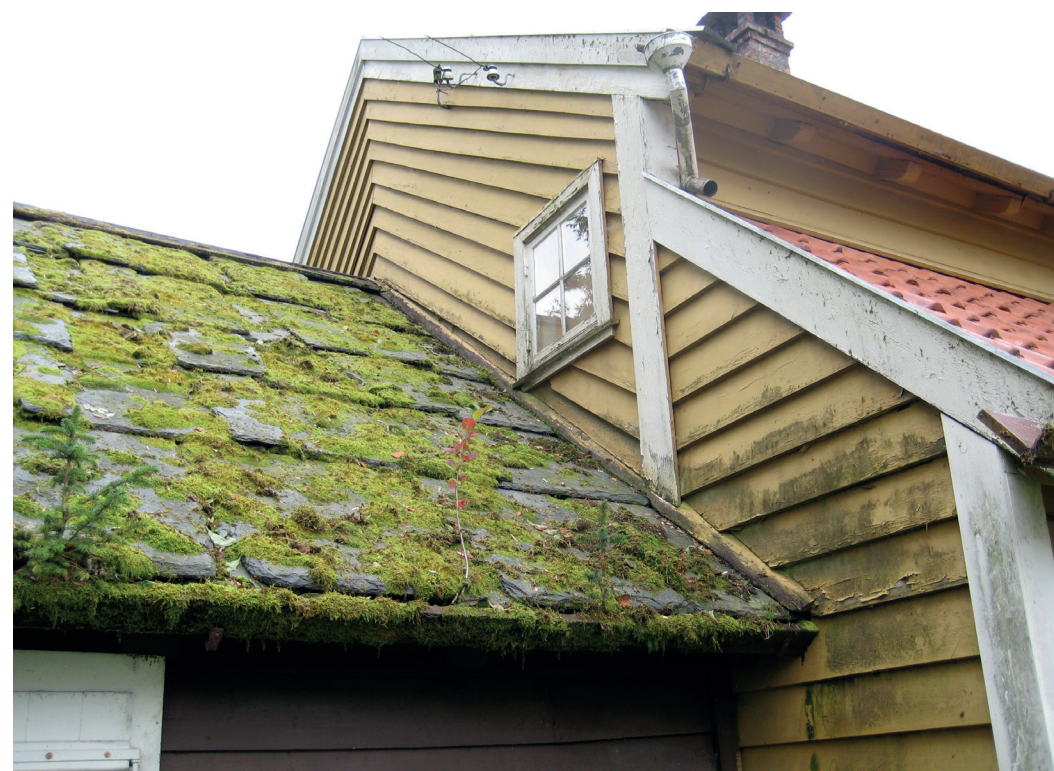
Klimaet blir fuktigere og fuktigere. Det påvirker vedlikeholdet av yttervegger. Foto: Tor Meusburger
