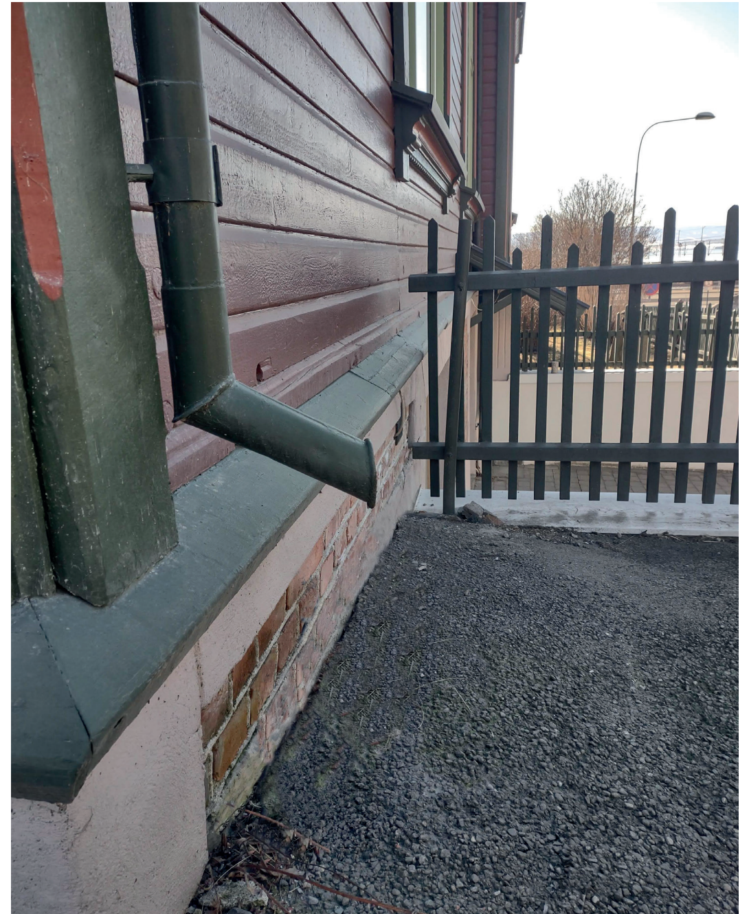
Villa Bergfall: Her leder nedløpet vannet godt ut fra grunnmuren og falsen er rettet vekk fra veggen. Foto: Villa Bergfall
