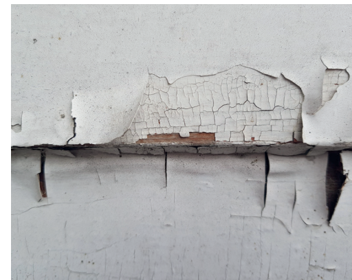
Her ser du tett plastmaling som løsner i store flak over det eldre laget med linoljemaling under. Linoljemaling krakelerer seg ofte slik. Foto: Fortidsminneforeningen/Hedda Skagen Paulson
