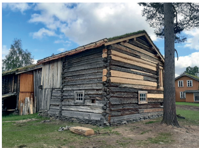
Ferdig restaurert. Stallåven i Museumsparken fikk en høyst nødvendig opprustning på sommeren, og framstår nå som et praktbygg. Foto: Jo Aspås.
