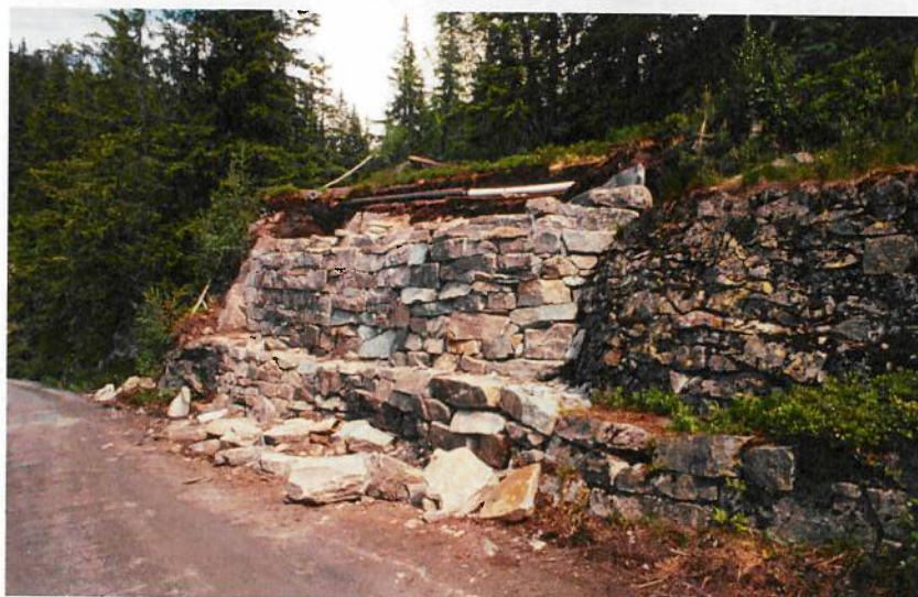
Mange renner har sidemurer som krever omfattende utskifting. Mellomrenna.
