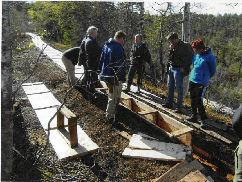
Statskogs styre på befarings ved en utskiftet del av Soldatergravene i 2009. Denne strekningen er en "klemmerenne" som er en yngre rennetype (ca. 1830) med innvendige trerammer og bordkledning. Vedlikeholdet er material- og arbeidskrevende.
