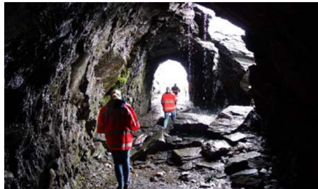
Allerede i 1900 ble det bygget en tunnel for å verne vegen mot ras. Tunnelen er der i dag, om enn i en litt dårlig forfatning etter at deler av taket har falt ned (Foto: Lars Helge Rasch)
