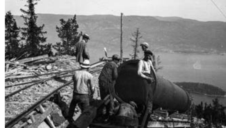
Anleggsarbeidere monterer rør for vanntilførsel til kraftstasjonen i Hakavik i 1921. Rørene ble levert på kaia, og deretter trukket oppover lia på en trallebane. (Foto: NVE/Digitaltmuseum.no)
