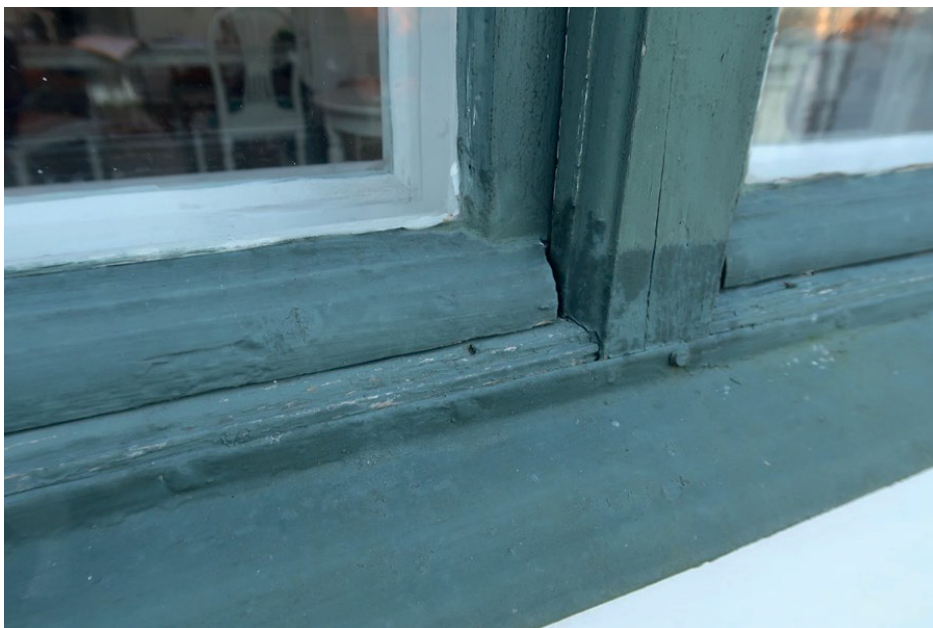
Figur 2. Fönsterparti före åtgärd. Droppnäsorna i trä är för korta sett till fönstrets bredd. En glipa uppstår mellan droppnäsa och mittpost. Dessutom har droppnäsorna för nätt utskjut, då de inte ens når över karmbottenstycket. Plåtbleck saknas. Foto: Ulrika Olsson, 2018-10-24.
