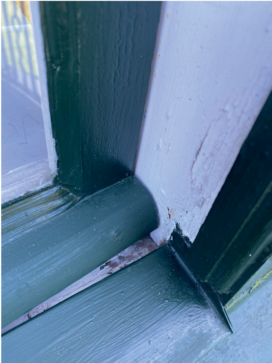
Figur 4. Åtgärdade bågar. Här framkommer hur tätt det är mellan droppnäsan och mittposten då fönstret öppnas, detta trots att droppnäsorna inte är utdragna riktigt lika långt som bågens bredd. Fotot visar också det nytillkomna plåtblecket, dess lutning samt uppdrag mot mittposten. Foto: Ulrika Olsson, 2021-09-13.
