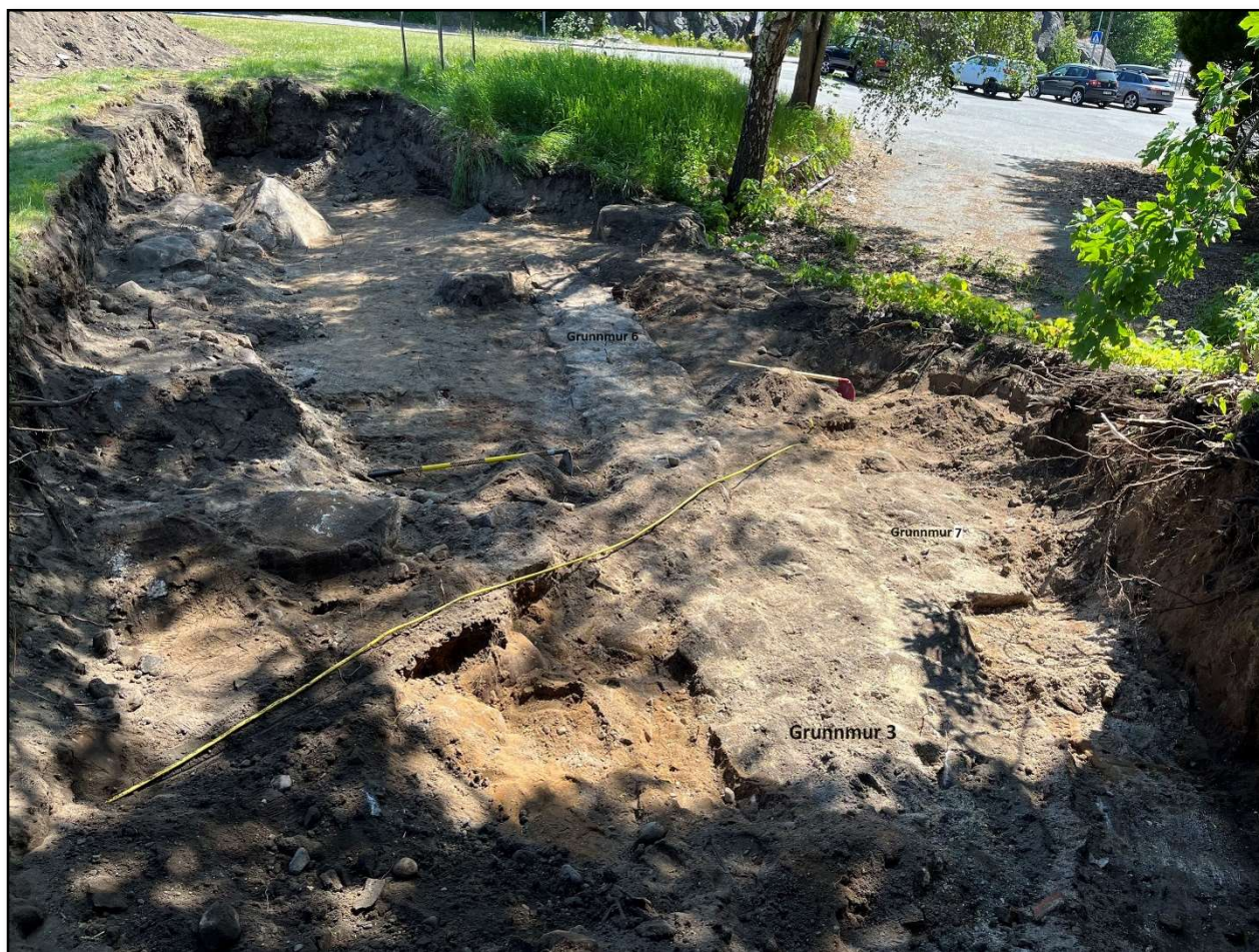
Figur 24. Oversikt over murene i sjakt 4 sett mot øst, med Grunnmur 3 lengst i forgrunnen. Bakover, i forlengelsen av Grunnmur 3, ligger Grunnmur 6. En gul telefonkabel ligger på skrå over murene, i en grøft som trolig stammer fra 1980-tallet. Foto: Julie Askjem, VTFK.
