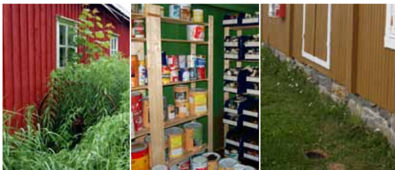
Fig. 17. Frå venstre: Vegetasjon veks heilt inn til museumsbygning, noko som i tørre periodar vil auke risikoen for spreing av ein eventuell brann. I midten: Eldsfarleg materiale er lagra i same lokale som naturhistorisk materiale. Til høgre: Spor etter eingongsgrill like ved ein husvegg.
