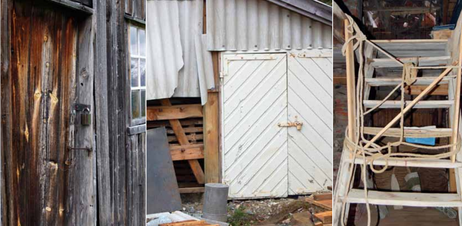
Fig. 23. Tjuverisikring er eit samansatt felt. Frå venstre: Det er ikkje så mykje nytte i ny lås, så lenge hengsel er enkel å fjerne. Det er heller ikkje så mykje hjelp i lås, når bygningsskalet er i dårleg stand. Til høgre ser ein mangelfull sikring mellom utstilling og loftsmagasin.
