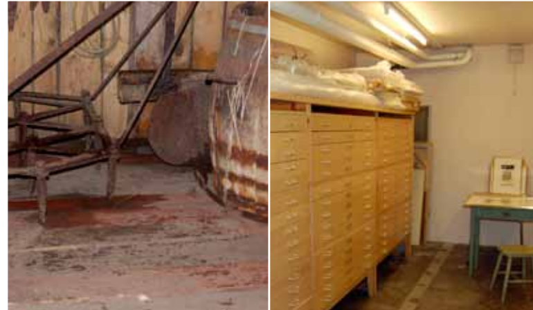
Fig. 10. Til venstre kan ein tydeleg sjå at det kjem vatn inn gjennom tak, medan ein til høgre ser ein potensiell risiko for vasskade i og med at det er vassførande røyr i taket.
