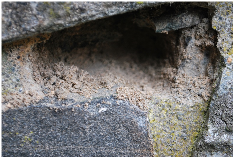
Forvitret kalkmørtel bak sementfuger
