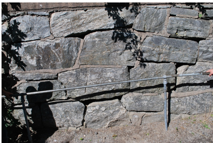
Forstøtningsmur med stedlig bearbeidet stein. Setninger og tett drenering er sannsynlig årsak til bevegelsene..
