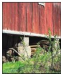
ELDES: At låven har blitt skjev over siden den ble oppført i 1890 levnes det liten tvil om.
