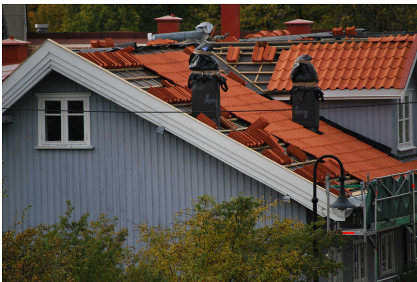
Utvendig etterisolering av tak medfører bredere vindskier og tap av stillidentitet. Nye teglsteinstyper krever også mer lufting under stein.
