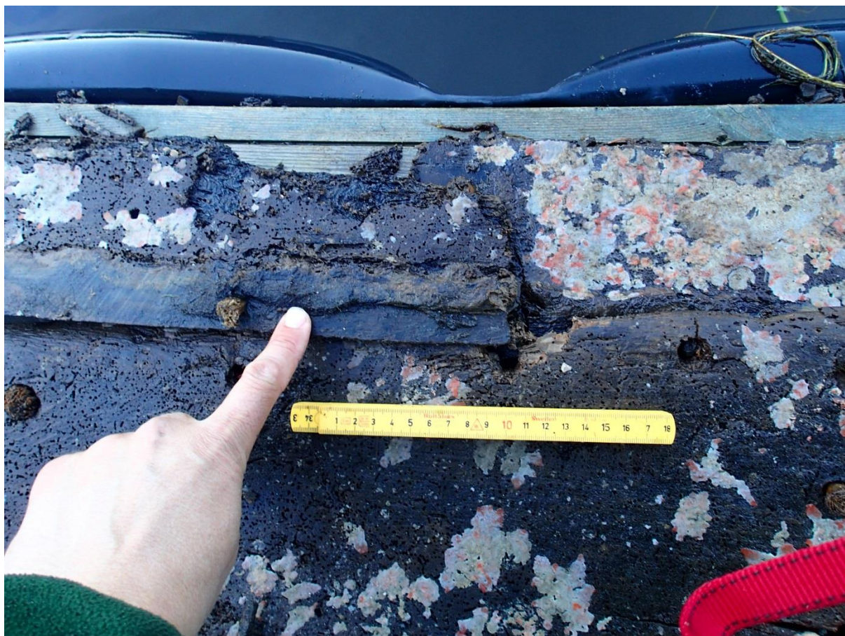
Figur 9 Tettingsmiddel i sua mellom bord 2b og 3. I sua kan man også se uregelmessige sagspor. På treverkets overflate hvor det ikke har vært overlapp mellom bordene er det tydelige skader etter pelemark. Foto: Elling Utvik Wamer/NMM.
