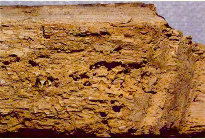
45. Skada av skäckig trägnagare i rötskadat lövträ.
