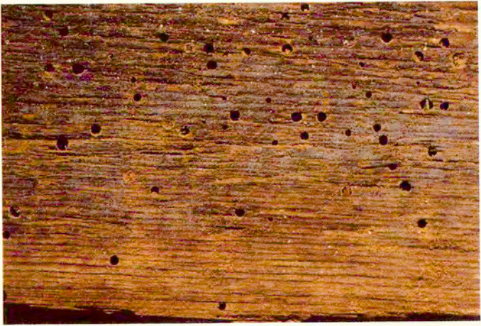
39. Skador av strimmig trägnagare. De runda flyghålen är 1,5–2 mm i diameter.
