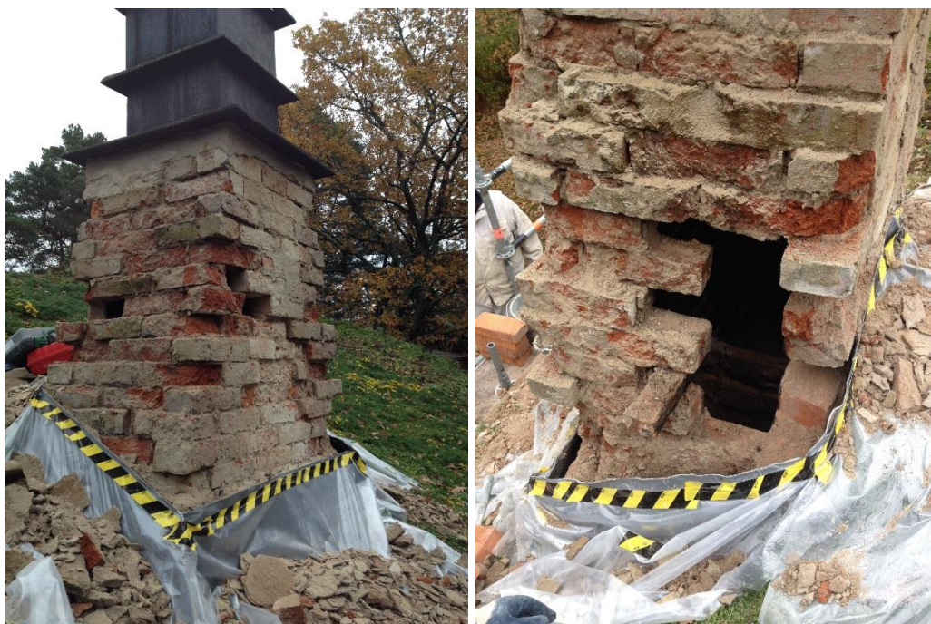
T.v. och t.h. Flera av tegelstenarna var frostsprängda och behövde bytas ut.
