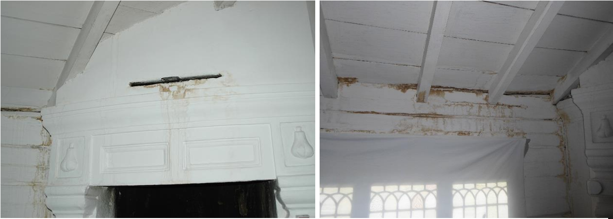
T.v. Läckage genom ventil, interiört.
